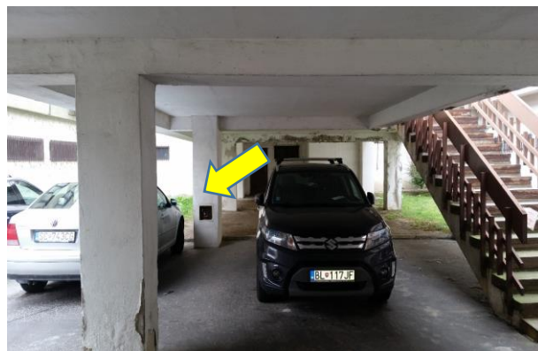
F2 – Kanalizácia v kastlíku stĺpa
