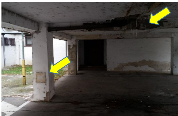
F1 – Existujúce zvody v havarijnom stave
